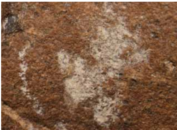
DETALLE DO DEPÓSITO DE BICARBONATOS
