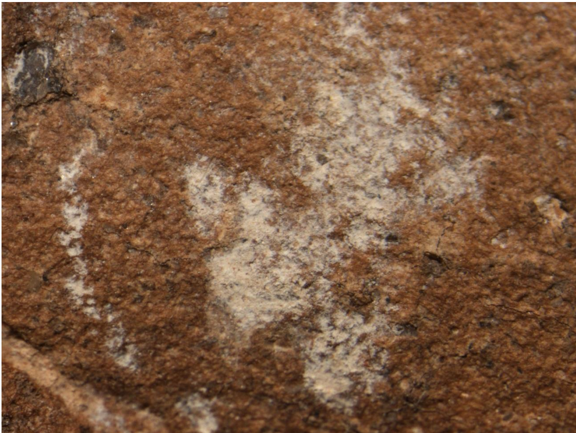
Detalle del depósito de bicarbonatos
